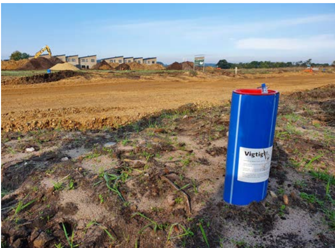
Tijdelijke inlaat op een nieuwe bouwplaats met een sensor in het deksel
