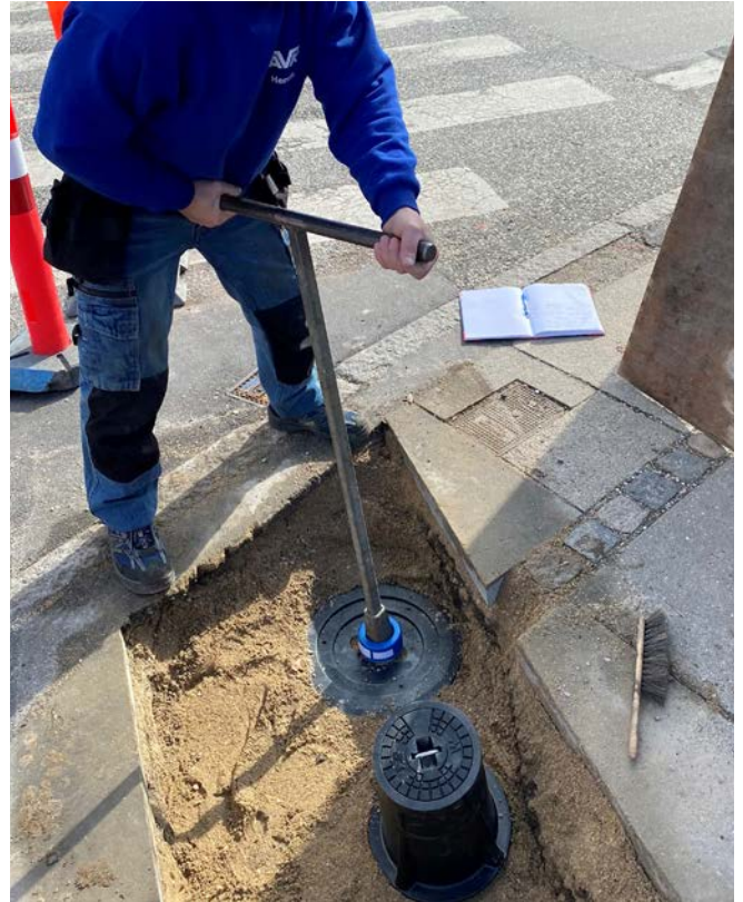
Ondergrondse afsluiter met VIDI positioner die detecteert wanneer de afsluiter wordt bediend.
